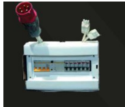
Электрощит 32А до 10кВт.
